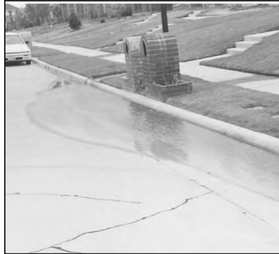
Facilité d'installation pour correction d'un problème de stagnation d'eau
